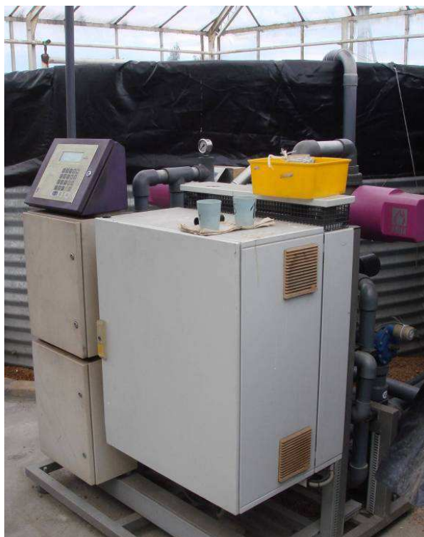
Fot. 28. Lampa UV Philips i system dezynfekcji pożywki „Vialux” PRIVA
