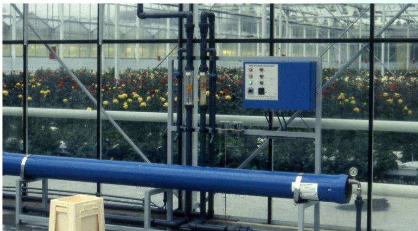
Fot. 27. Filtr odwróconej osmozy zastosowany do oczyszczania wody w szklarniowym systemie zamglawiania
