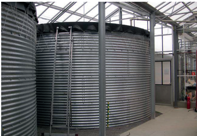
Fot. 17. Buforowe zbiorniki na wodę umieszczone wewnątrz szklarni. (W. Treder)
